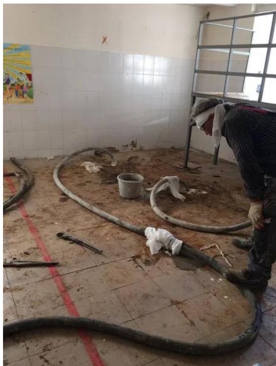
Рис. 3 – Использование гибких иньекторов для цементации грунтов (предложенная и реализованная на объекте технология)
