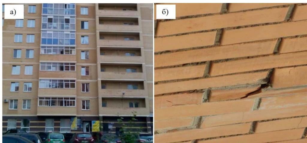
Рис. 1. – Объект исследования: многоквартирный жилой дом а) общий вид; б) отслоение лицевого слоя кирпича
