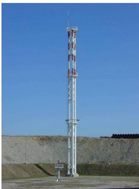
Рис. 1. – Внешний вид опоры молниеприемника
